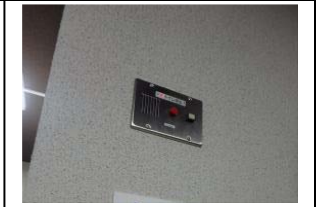
・緊急呼び出し装置のロビー側のインターホン
