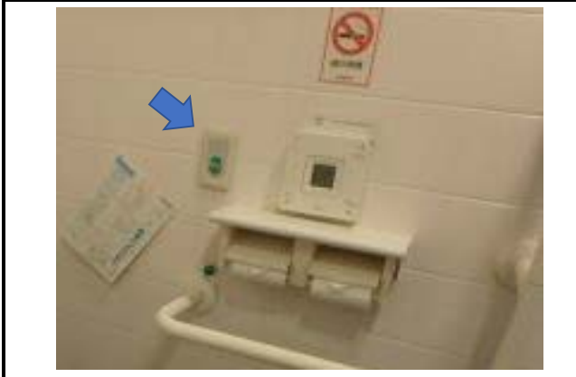
・緊急呼び出しボタンが設置されている
