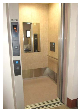
車椅子対応エレベーター
