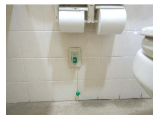
非常警報装置
