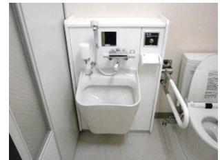
オストメイト用洗浄設備
