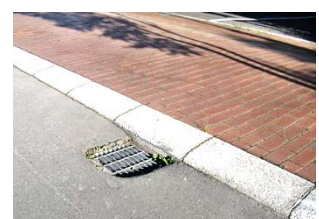
道路・歩道の段差
